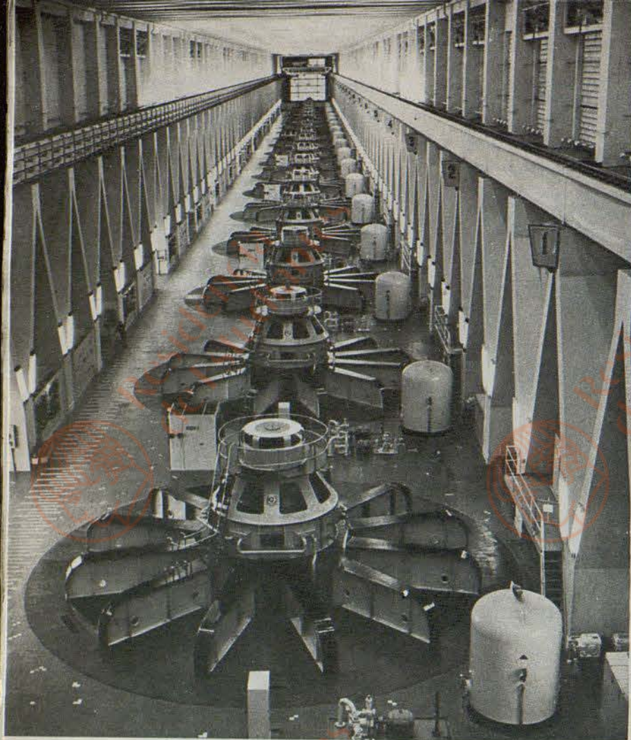
Машинный зал Братской ГЭС.
